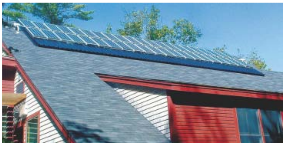
Abbildung 2 Diese PV/T-Luftkollektoren – SolarRoof von Conserval Engineering Inc. – sind am Chewonki Center for Environmental Education in Wiscasset, Maine, USA installiert
